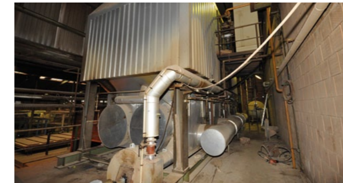
Regenerative Abgasnachverbrennung im Gebäude Flue gas post-combustion inside the building
