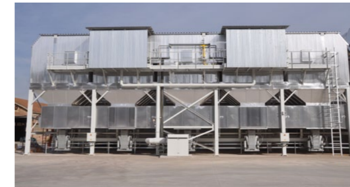
Regenerative Abgasnachverbrennung außerhalb Flue gas post-combustion outside
