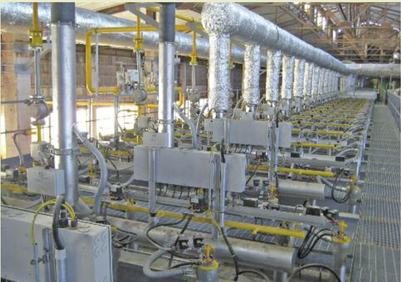
Deckenbefeuerter Tunnelofen mit Gasbrennern
