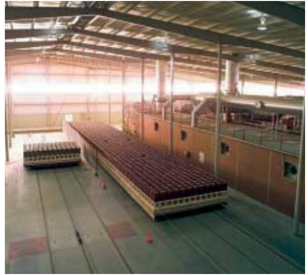
Bild 2: Blick auf den Lingl-Durchlaufrockner Fig. 2: View on the continuous dryer
