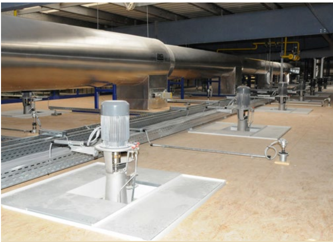
Trocknerdecke mit Drehlüftern Dryer roof with rotary fans
