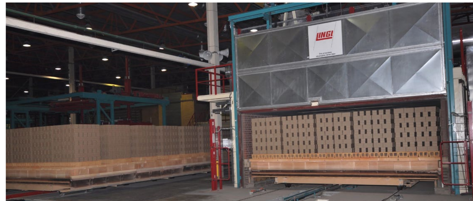
Tunnel Kiln Entrance въезд в туннельную печь
