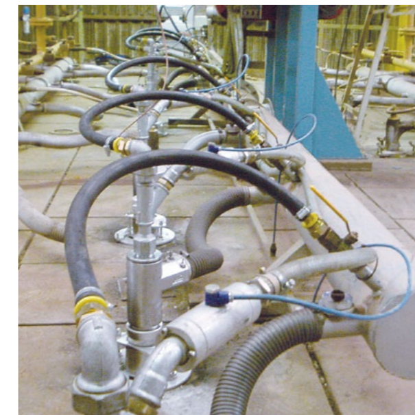
Festbrennstoff-Feuerung Solid fuel firing system
