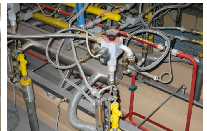
Dualbrennanlage für Pflanzenöl und Erdgas Dual fuel firing system for vegetable oil and natural gas
